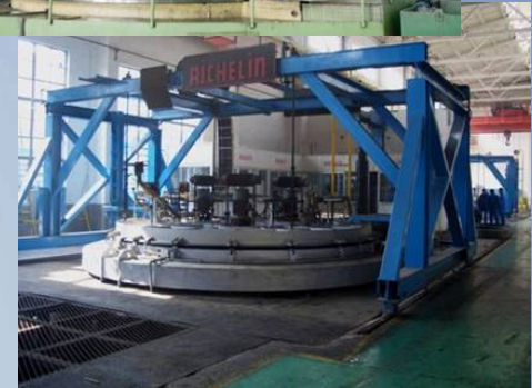
热处理渗碳炉
